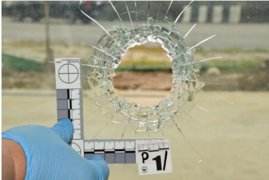
ภาพที่ ๔ แสดงสภาพและขนาดของรูรอย บนประตูกระจกบานเลื่อนด้านในของอาคาร
